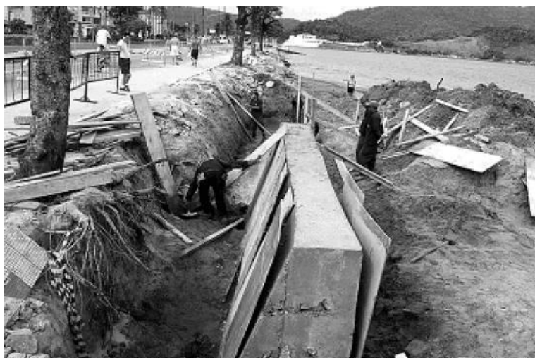
Figura 3.1.9. Construção de um muro de contenção na Av. Bartolomeu de Gusmão, como registrado na edição de 18 de maio de 2005 do Diário Oficial de Santos - Cada fôrma da muralha tem 6 m de comprimento por 2,5 m de altura. Fonte: Site Novo Milênio 31 .
