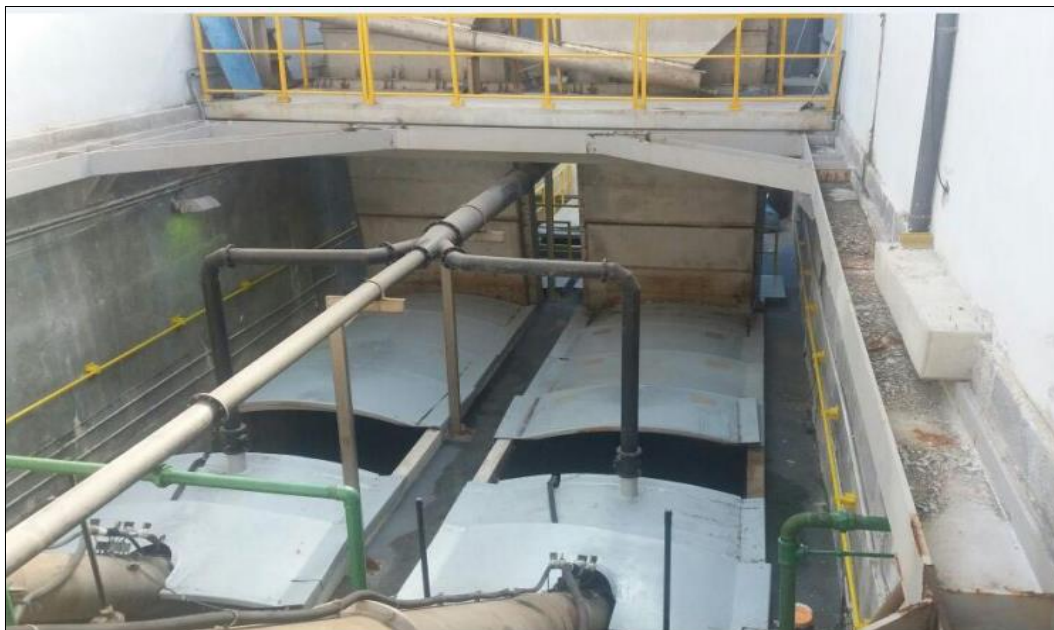
Figura 29 – EPC Santos / José Menino: Unidade de Peneiramento e Gradeamento.
