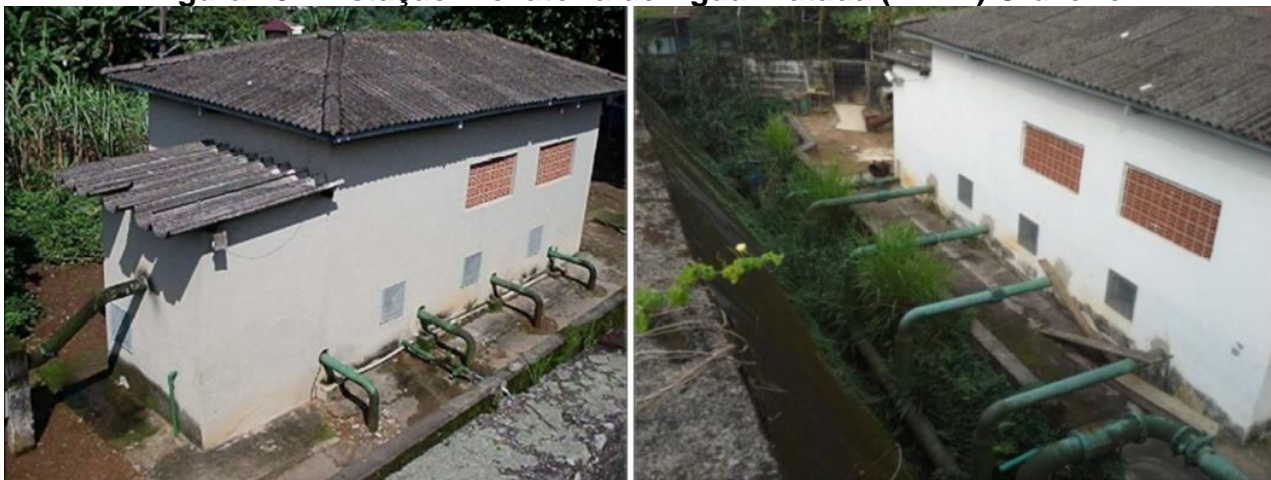
Figura 25 – Estação Elevatória de Água Tratada (EEAT) Cruzeiro.
